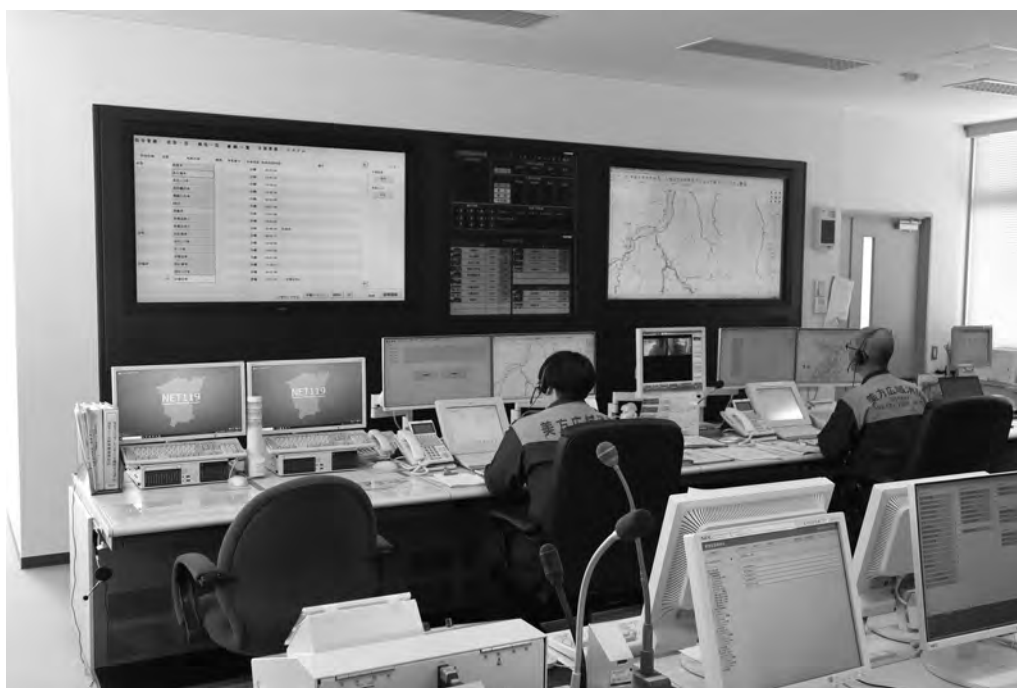
高機能消防通信指令施設
